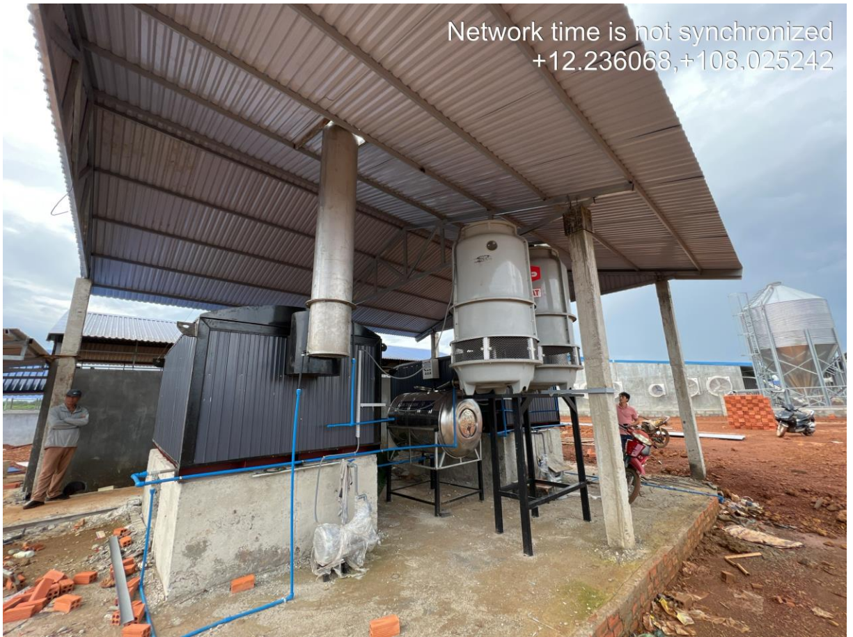
Hình 3.17: Hệ thống xử lý khí thải thực tế tại trang trại
