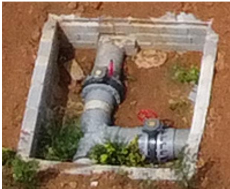
Hình 3.5: Hệ thống ống thu gom nước thải hiện tại của trang trại
